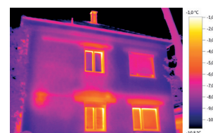
Imagine termică cu ScaleAssist
