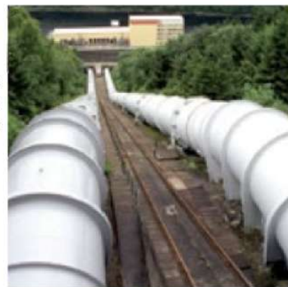
Fabrică de hidroenergie cu conducte
