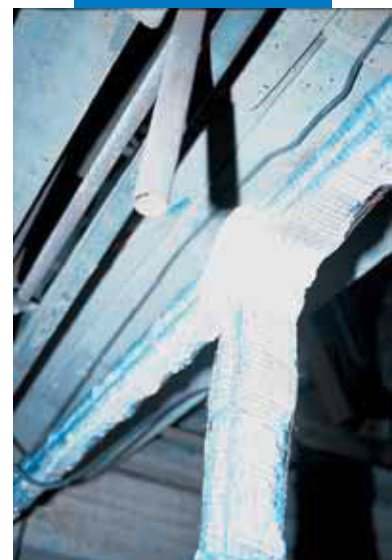
Deteriorarea structurii din beton
